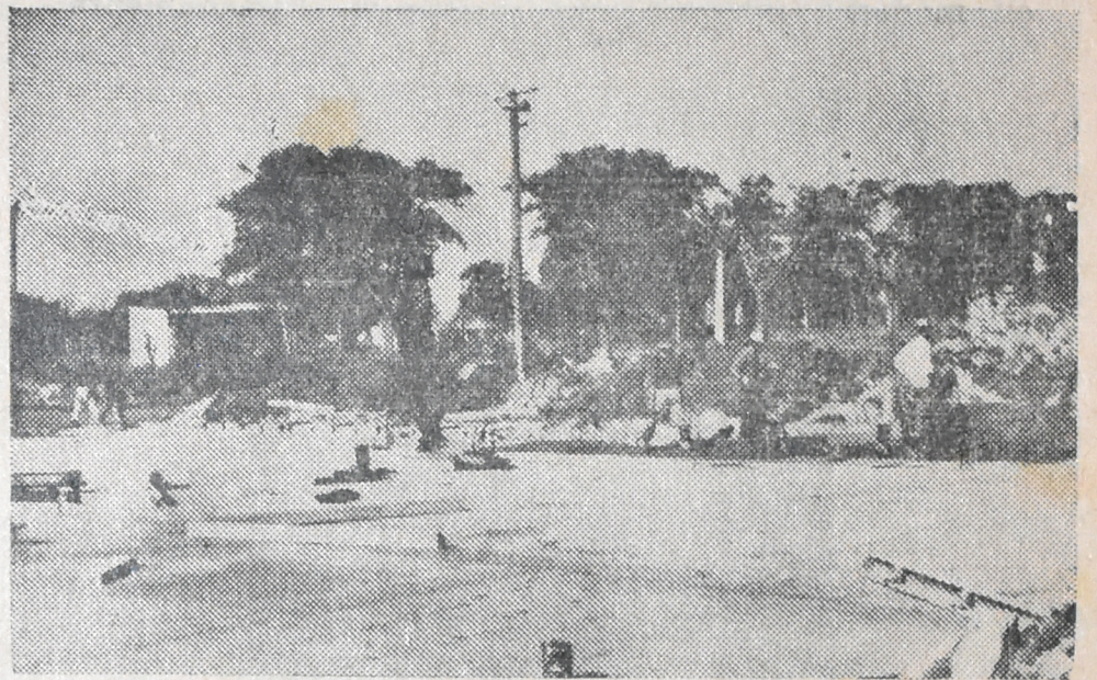
Los trabajos de afirmado en la Avda. San Martín, sector a remodelarse - Obra Ing. Giandana
