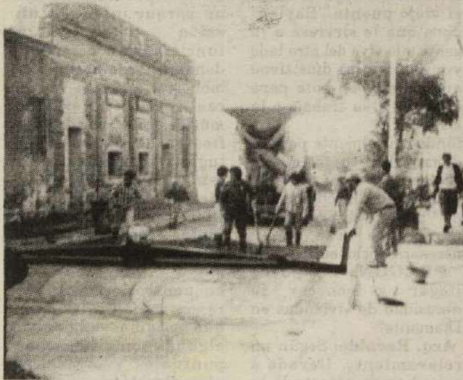
Obras en Belgrano, entre T. del Pilar y Dr. López (Foto "PREGON")
