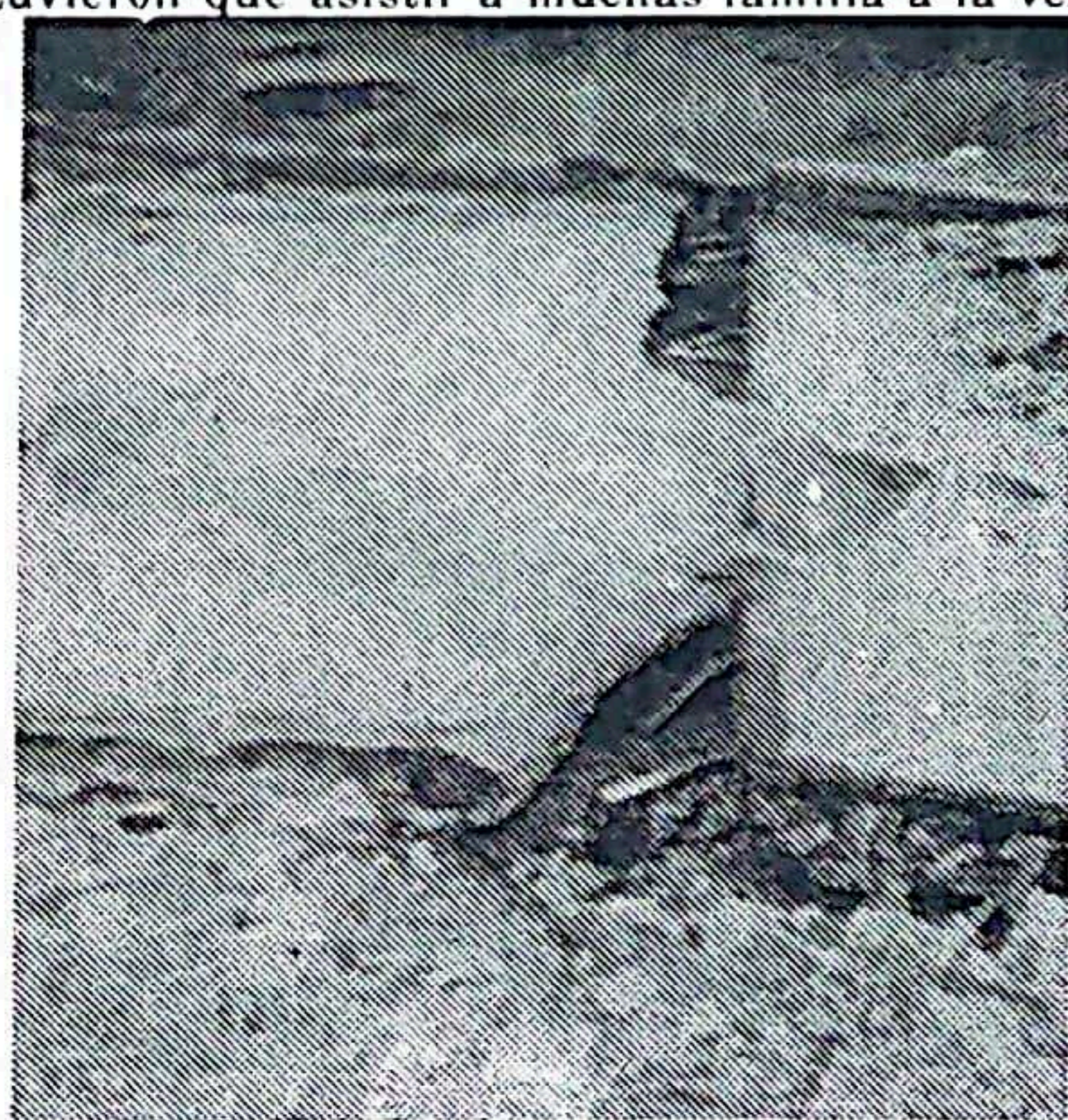
Pavimento levantado en la calle "Sara Romero" Foto Pregon
